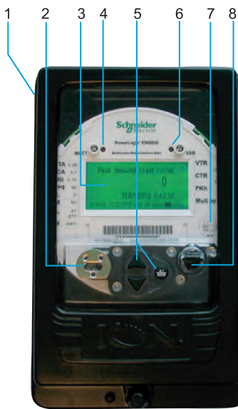
PowerLogic ION8650 в щитке
